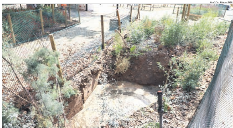
Se abrieron varias zanjas para detectar la fuga y una se inundó, como esta del parque de Riu Ebre.
