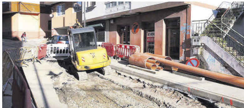
Imagen de archivo de obras en la calle Batalla del Callao hundida por una fuga de agua. | S.A.
