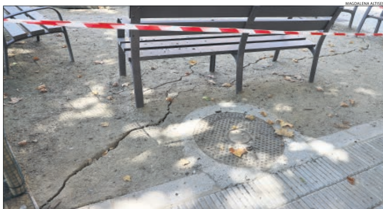
Las filtraciones de agua provocaron la aparición de grietas en un tramo de la nueva rambla verde.
