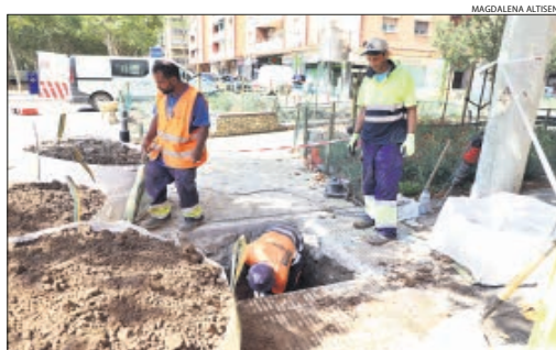
Los operarios trabajan desde el miércoles para detectar la fuga.
